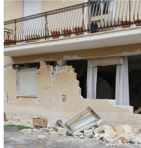
Figura 20. Daño en elementos estructurales y no estructurales por su interacción durante sismo. (Sanchez, J. 2019) Fuente: Base de datos de SPRINT-Lab de la Universidad de Udine.
