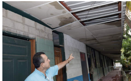
Figura 19. (a) Vista general de elementos no estructurales 8 (b) Daños en cielo falso 9
