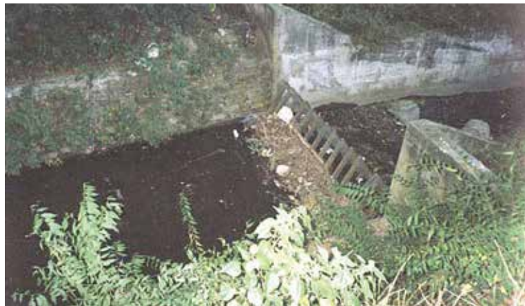
Caramera, dispositivo metálico empotrado que retiene desechos sólidos que arrastra la quebrada.
