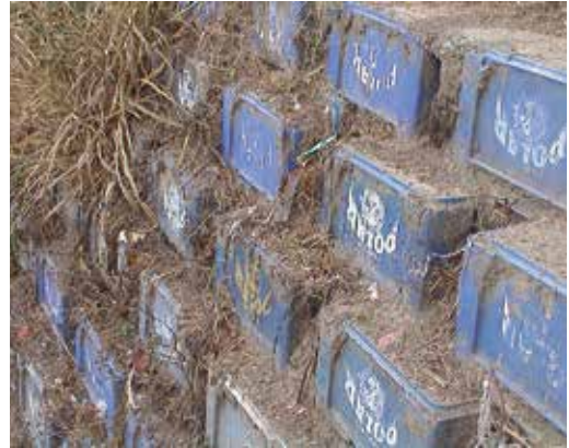
Muro de contención con gaveras de cerveza
