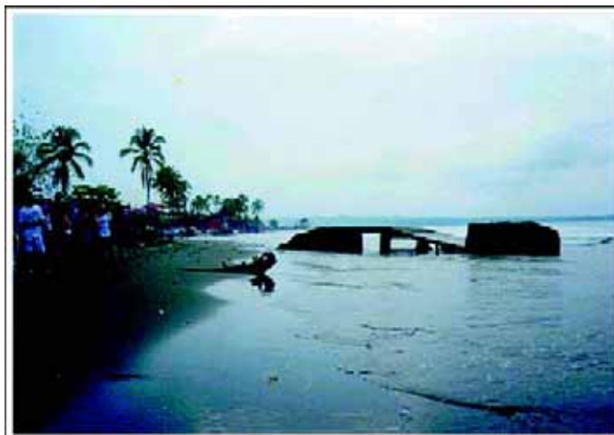
Figura II.1-1 Estado de la carretera que bordea un sector de Juanchaco, Valle, después de ocurrida la fase máxima del evento 1997-98 (Foto tomada en marzo de 1998)
