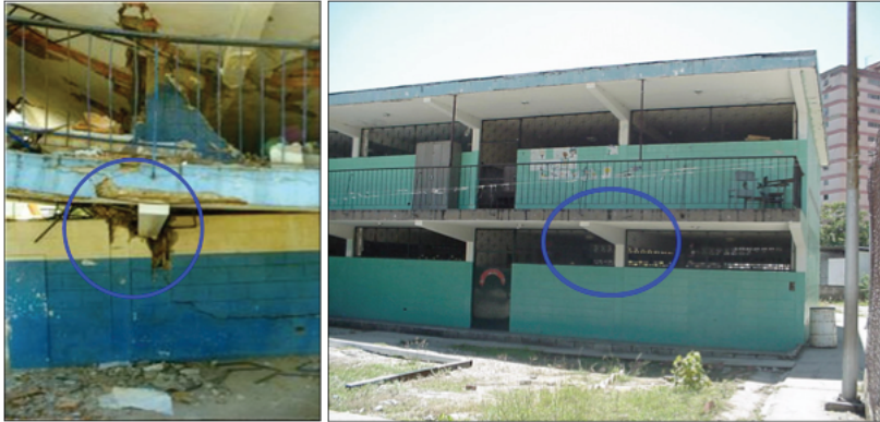
Figura 2.24 Efectos de elementos no estructurales: efecto de “columna corta” ocasionado por la tabiquería de relleno. La fotografía de la izquierda muestra la falla en columna corta de la escuela Valentín Valiente (sismo de Cariaco, Venezuela, 1997). A la derecha, una columna similar en escuela idéntica (Fotografías: FUNVISIS, Oscar A. López).
