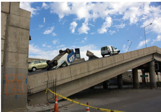
Figura 1.12 Terremoto de Maule, Chile (27 de febrero de 2010). Daños en la autopista Vespucio Norte (Fotografía: Esteban Maldonado). http://commons.wikimedia.org/wiki/File:Vespucio_Norte_Highway_after_2010_earthquake.jpg?uselang=es
