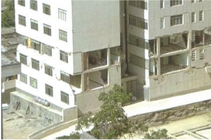
Figura 4.13 Caída de paredes de mampostería de relleno en Caracas durante el sismo de 1967 (Fuente: Steinbrugge, K. V., 1967).
