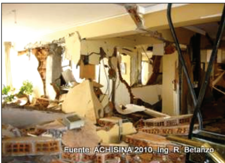
Figura 3.15 Fallas en elementos no estructurales. Terremoto de Chile (2010) (Fotografía: R. Betanzo, ACHISINA).
