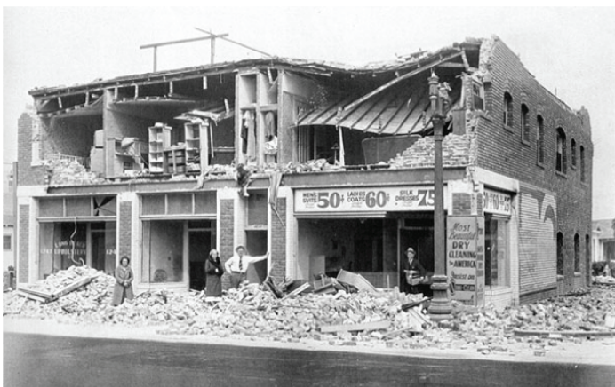
Figura 3.1 Terremoto de Long Beach (marzo de 1933). Daños en edificaciones, característicos de la mampostería no reforzada (Fuente: The Historical Society of Long Beach , 1981). http://www.scec.org/education/030310longbeach.html
