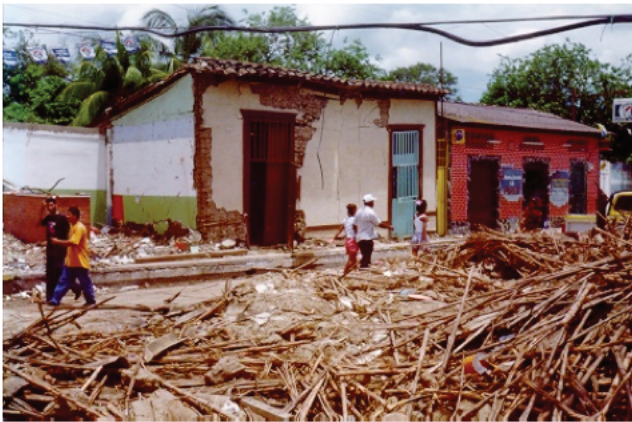
Figura 5.5 Sismo del Pilar del 11 de junio de 1986. Las viviendas de adobe y mampostería sin refuerzo, muy peligrosas en zonas sísmicas, siguen tolerándose en algunos países de la región (Fotografía: Marianela Lafuente).
