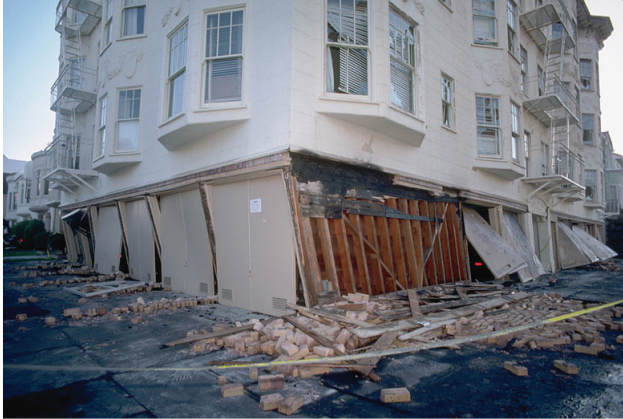
Figura 5.7 Terremoto de Loma Prieta, California (1989). Daños en el primer piso de un edificio (piso “débil”). http://commons.wikimedia.org/wiki/File:LomaPrieta-Marina.jpeg
