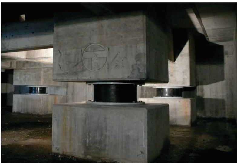
Figura 6.11 Uso de aisladores sísmicos en Chile (Fotografía: TENSOCRET). http://www.tensocret.com
